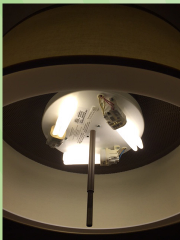
Original Install 3x 13w CFL 39w Total Per Fixture
